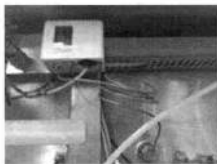
Figura 14 - Termostato da resistência de AR
