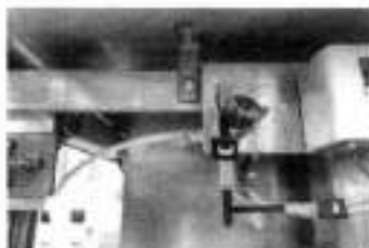
Figura 10 - Pressostato de AR nas canaletas
