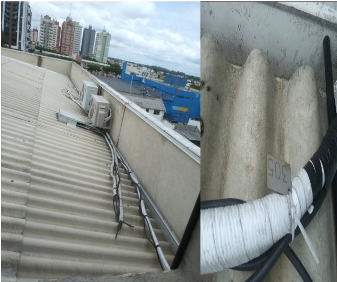
Figura 3 - Local de Instalação da Condensadora do Aparelho de Ar Condicionado com preparação.
