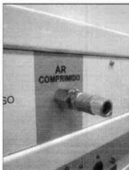
Figura 2 – ITEM 2: CONEXÃO MEDICINAL DE AR COMPRIMIDO
