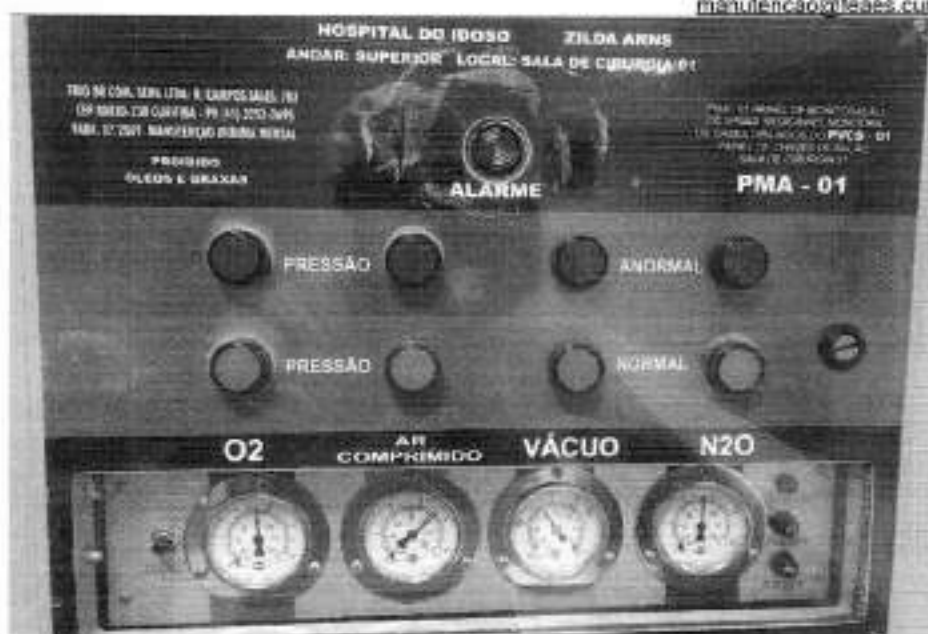
Figura 20 – PAINEL DE ALARME /MONITORAMENTO OXIGÊNIO / AR COMPRIMIDO / VÁCUO / ÓXIDO NITROSO
