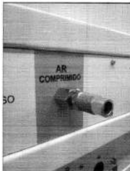
Figura 2 – ITEM 2: CONEXÃO MEDICINAL DE AR COMPRIMIDO
