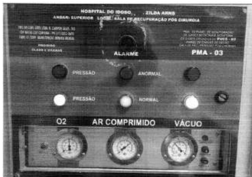
Figura 21 – PAINEL DE ALARME / MONITORAMENTO OXIGÊNIO / AR COMPRIMIDO / VÁCUO
