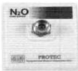
Figura 16 – ITEM 21: POSTO PAREDE EXTERNO (CANOPLA) ÓXIDO NITROSO
