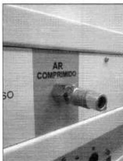
Figura 2 – ITEM 2: CONEXÃO MEDICINAL DE AR COMPRIMIDO
