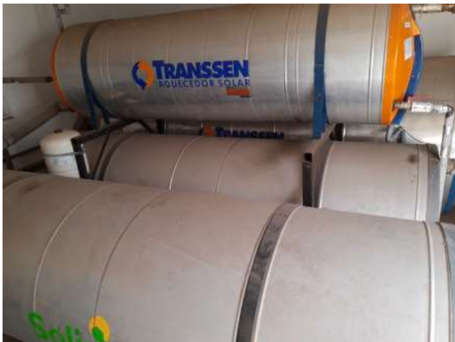
Figura 4 – Tanque (Reservatório térmico) HMIZA:
