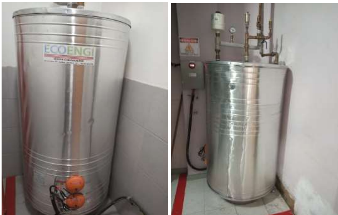
Figura 6 - Reservatório Térmico Vertical CMCBN:
