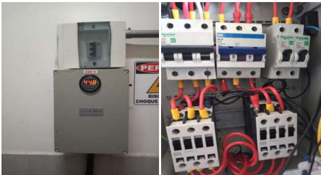
Figura 7 - Controlador Digital com Contatora e Disjuntor CMCBN:
