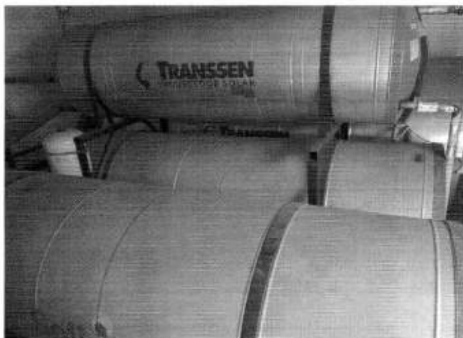
Figura 4 – Tanque (Reservatório térmico) HMIZA:
